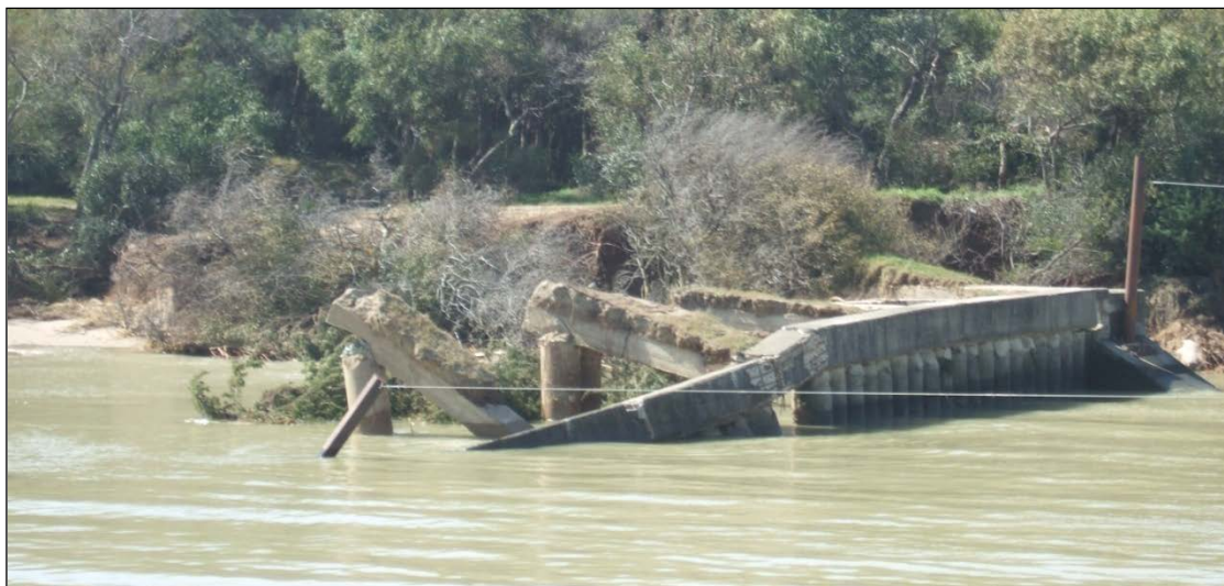
Figura 9 - Vista del molo destro della foce del torrente Galaso che è stato parzialmente demolito dalla piena
