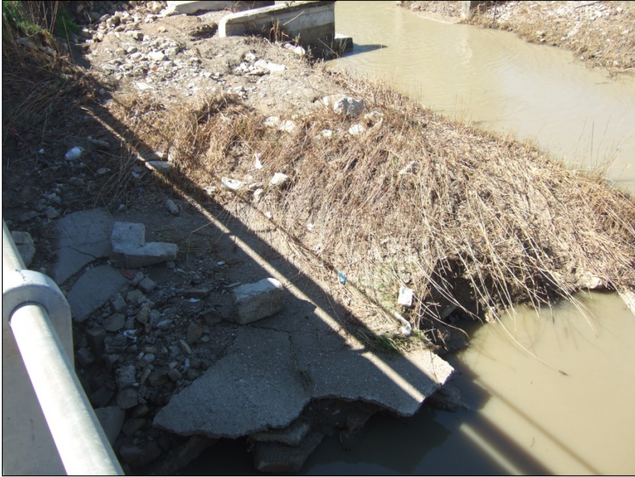
Figura 7 - Vista di un particolare della sponda destra idraulica della confluenza del collettore della Marinella nel torrente Galaso con la presenza di depositi di sedimenti e di materiale vario trascinato dalla corrente
