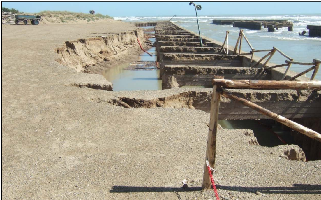
Figura 8 - Vista del molo sinistro della foce del torrente Galaso il cui materiale di riempimento a tergo è stato eroso
