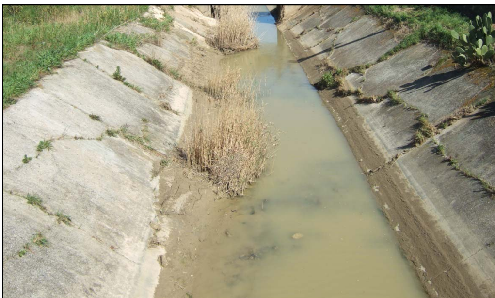
Figura 16: Vista del collettore della Marinella sul cui fondo sono presenti dei depositi di sedimenti
