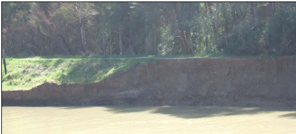
Figura 14: Particolare dell' argine destro del torrente Galaso, rimaneggiato dall' alluvione, situato immediatamente a valle della confluenza del canale Salinella
