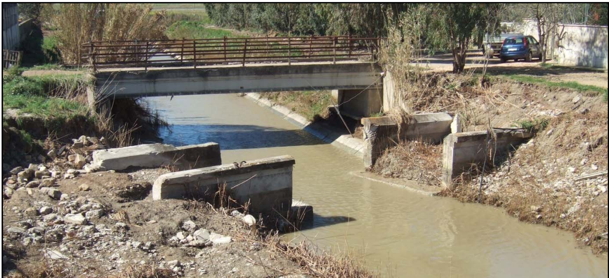
Figura 20: Vista delle spalle del vecchio attraversamento situato lungo il collettore della Marinella in corrispondenza dell' immissione nel torrente Galaso
