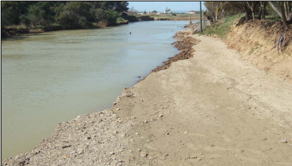
Figura 19: Vista da valle dei rimaneggiamenti sulla sponda sinistra idraulica del torrente Galaso nelle vicinanze della foce
