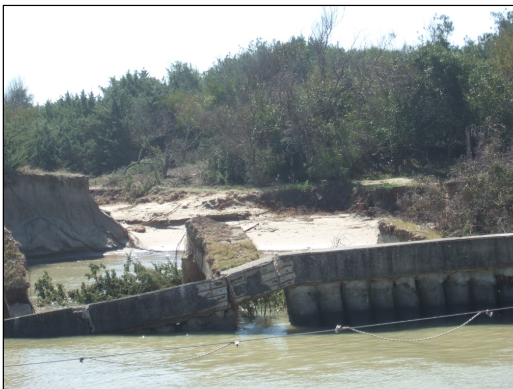
Figura 15: Vista della breccia (oltre che dei danni al molo oggetto dell' intervento di rinaturalizzazione 3) lungo l' argine destro del torrente Galaso nel tratto terminale
