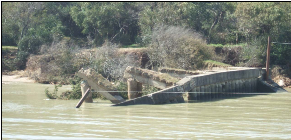
Figura 24: Vista del molo destro della foce del torrente Galaso che è stato parzialmente demolito dalla piena
