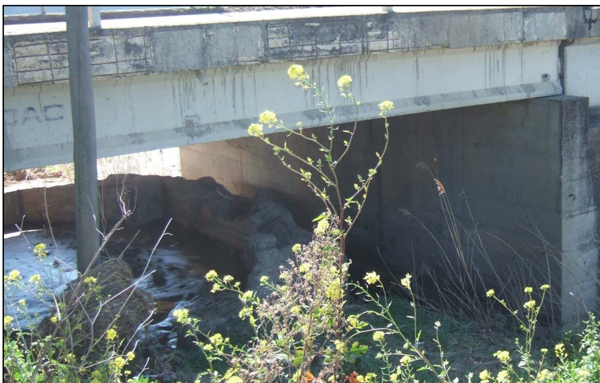
Figura 22: Vista della spalla sinistra del vecchio attraversamento di viale Ionio situato al di sotto di quello attuale
