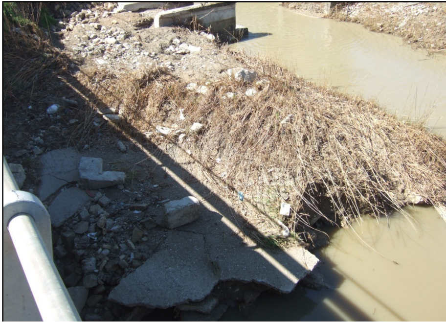
Figura 17: Vista di un particolare della sponda destra idraulica della confluenza del collettore della Marinella nel torrente Galaso con la presenza di depositi di sedimenti e di materiale vario trascinato dalla corrente
