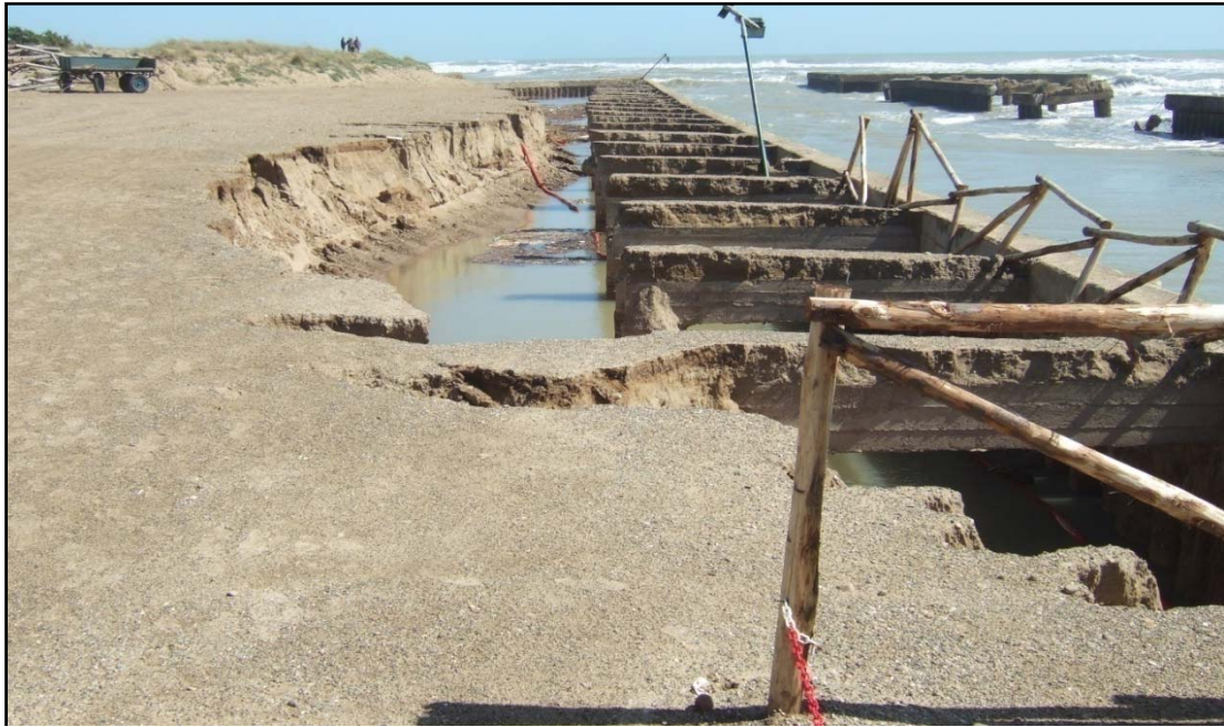
Figura 23: Vista del molo sinistro della foce del torrente Galaso il cui materiale di riempimento a tergo è stato eroso
