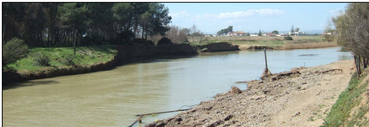
Figura 12: Vista del rimaneggiamento dell' argine destro del torrente Galaso nel tratto situato immediatamente a valle della confluenza del canale Salinella
