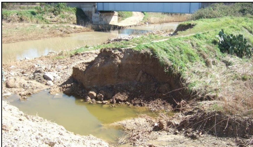
Figura 11: Vista della breccia lungo l' argine destro del torrente Galaso nel tratto compreso tra l' attraversamento di viale Ionio e l' attraversamento ferroviario (tratto già riparato dall' Amministrazione Comunale con altri fondi)
