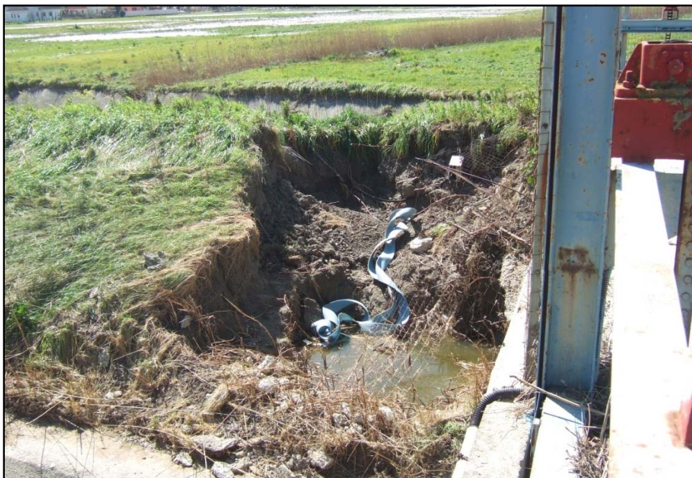
Figura 8: Vista della breccia dell’ argine destro del collettore della Marinella situata all’ altezza dell’ organo di sottopasso del terzo colatore della Marinella
