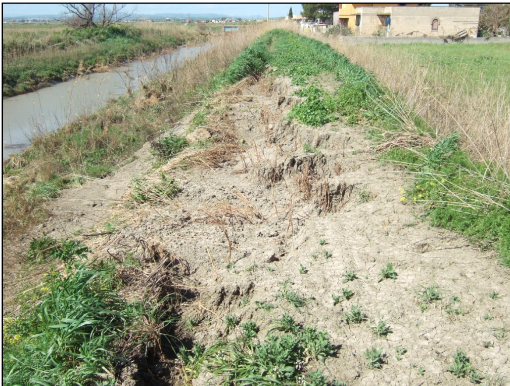
Figura 10: Vista dei danneggiamenti subiti dall' argine sinistro del collettore della Marinella, posto di fronte alla breccia della figura precedente, a causa dell' impatto e del sormonto della corrente in piena
