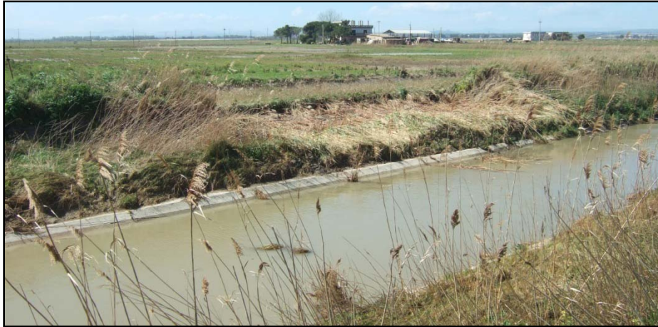
Figura 9: Vista della breccia dell' argine destro del collettore della Marinella situata a monte della paratoia di scarico delle acque alte del terzo colatore della Marinella nello stesso collettore della Marinella
