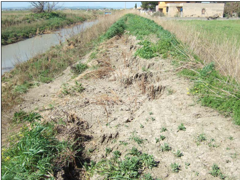
Figura 4: Vista dei danneggiamenti subiti dall' argine sinistro del collettore della Marinella, posto di fronte alla breccia della figura precedente, a causa dell' impatto e del sormonto della corrente in piena
