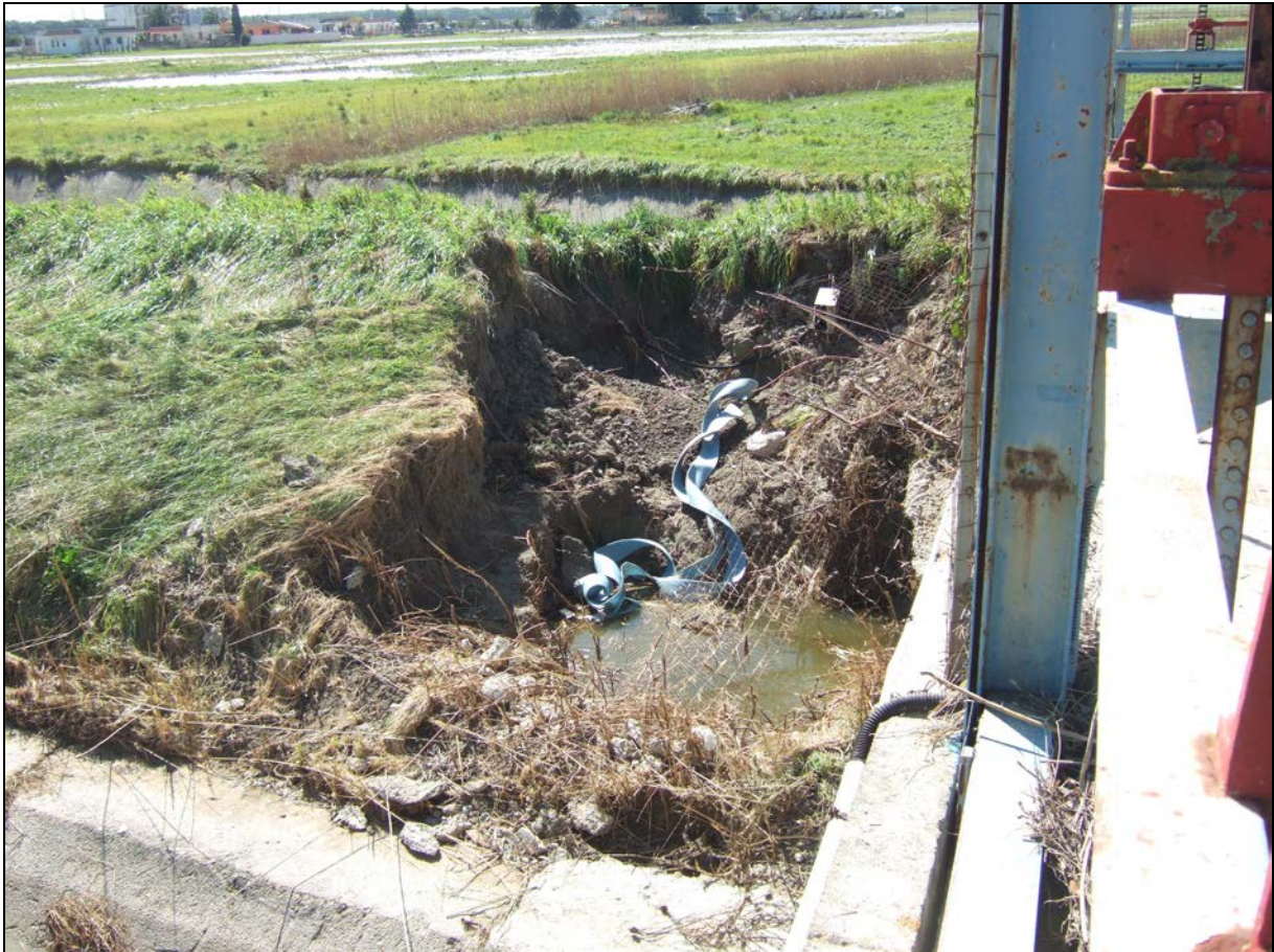
Figura 2: Vista della breccia dell' argine destro del collettore della Marinella situata all' altezza dell' organo di sottopasso del terzo colatore della Marinella
