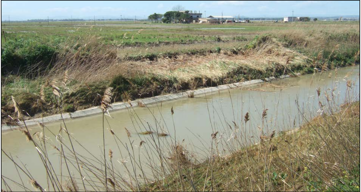
Figura 3: Vista della breccia dell' argine destro del collettore della Marinella situata a monte della paratoia di scarico delle acque alte del terzo colatore della Marinella nello stesso collettore della Marinella
