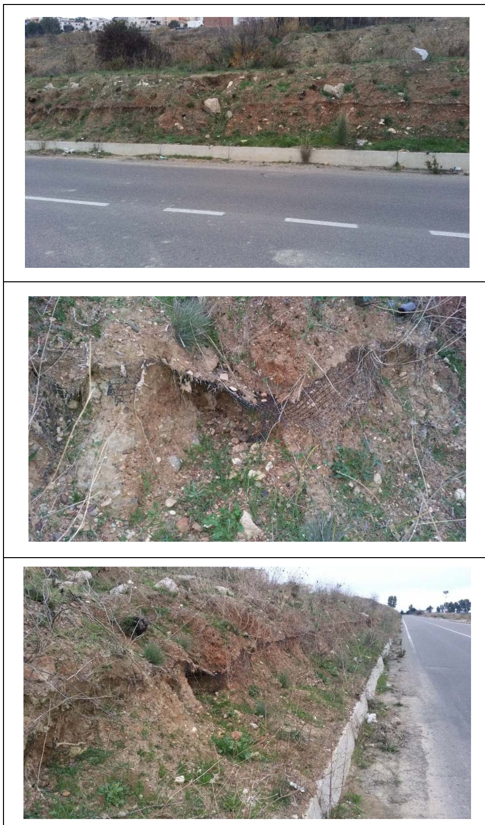
Fig. 1: Dissesti sulla strada circonvallazione sud
