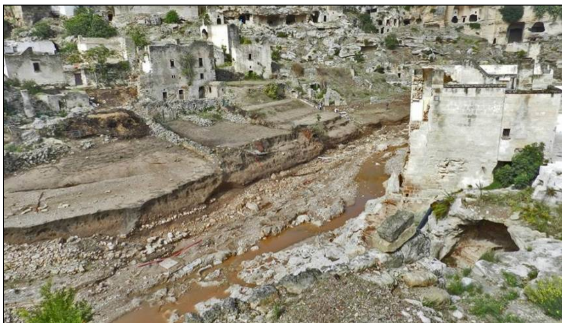
Fig. 11: Alluvione di Ginosa: scalzamento al piede delle sponde (2013)
