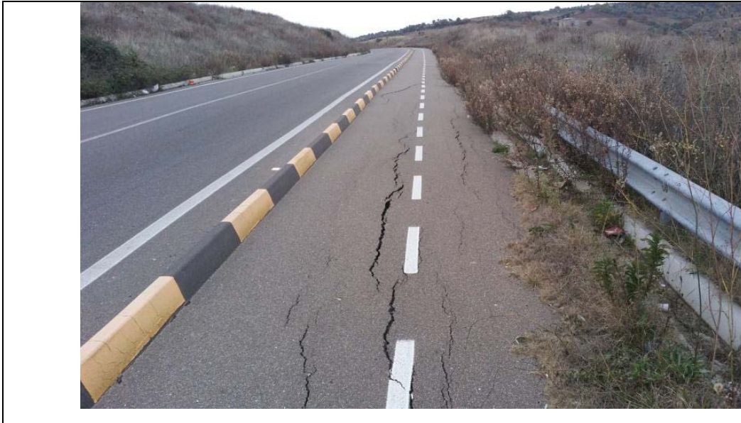
Fig. 6: Dissesti sulla strada circonvallazione sud
