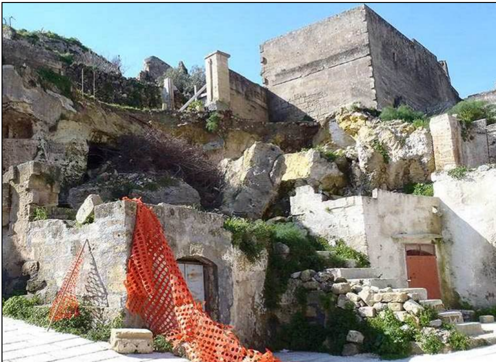
Fig. 14: Crollo in Via San Giovanni (situazione post crollo)
