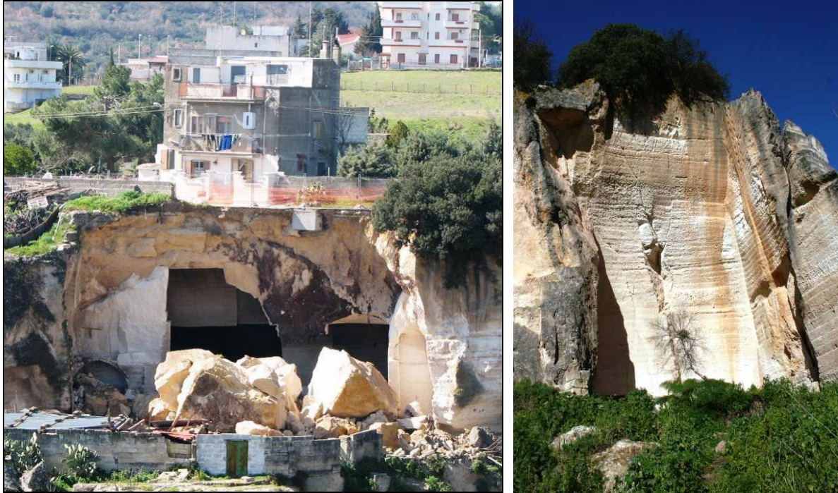
Fig. 12: Dissesti su Via Pescara: crollo ingresso cava (sinistra) - fratturazione ammasso roccioso (destra)
